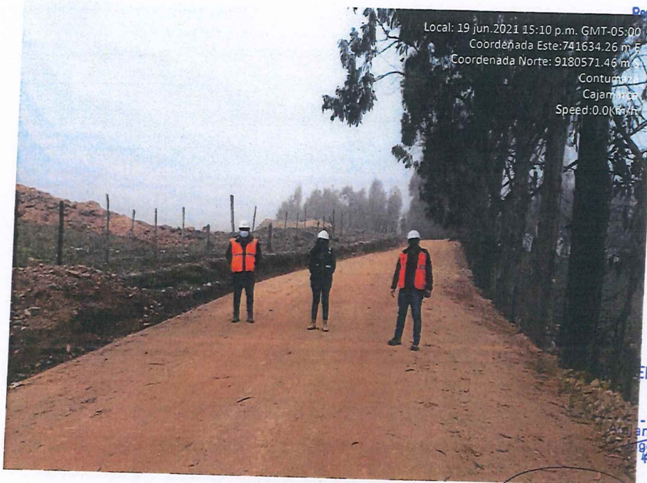
Fotografía 52. Resultado de la compactación del afirmado, verificación de los trabajos en campo por parte de la Entidad y visita de la supervisión por parte de Provias.
