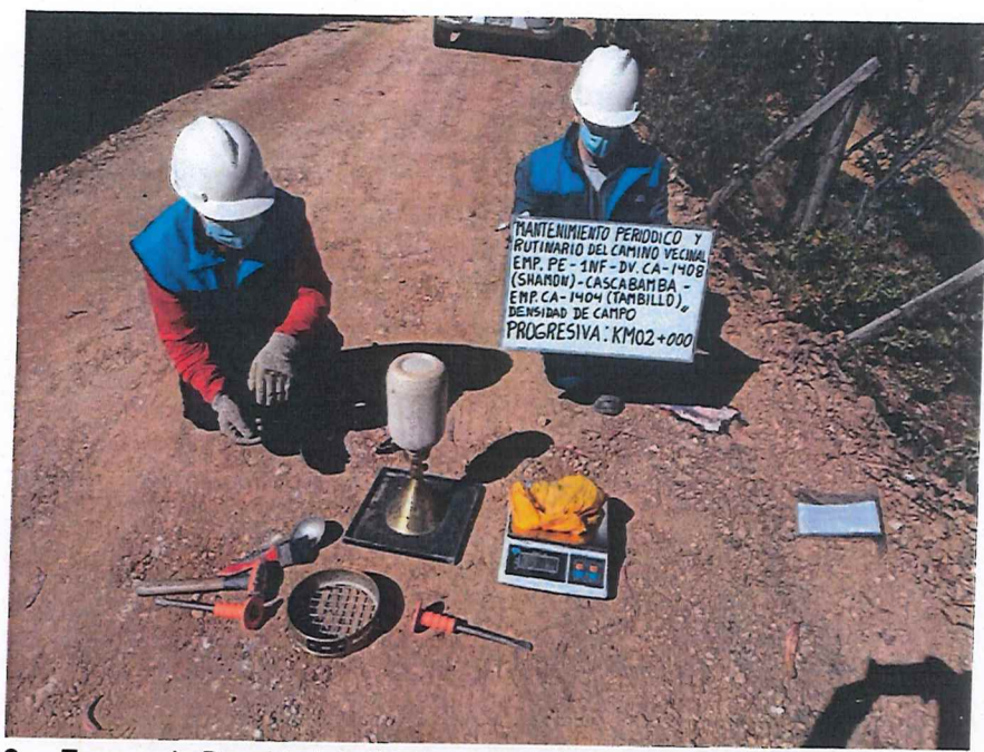
FIGURA N° 9. Ensayo de Densidad de Suelo en Campo. Progresiva 02 + 000 (Método del cono de arena).
