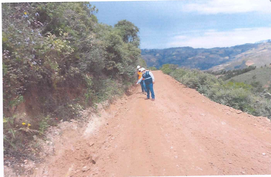
SE OBSERVA AL INSPECTOR DEL SERVICIO, CONJUNTAMENTE CON RESIDENTE VERIFICANDO LA CONFORMACION DE LAS CUNETAS DEL MANTENIMIENTO.
