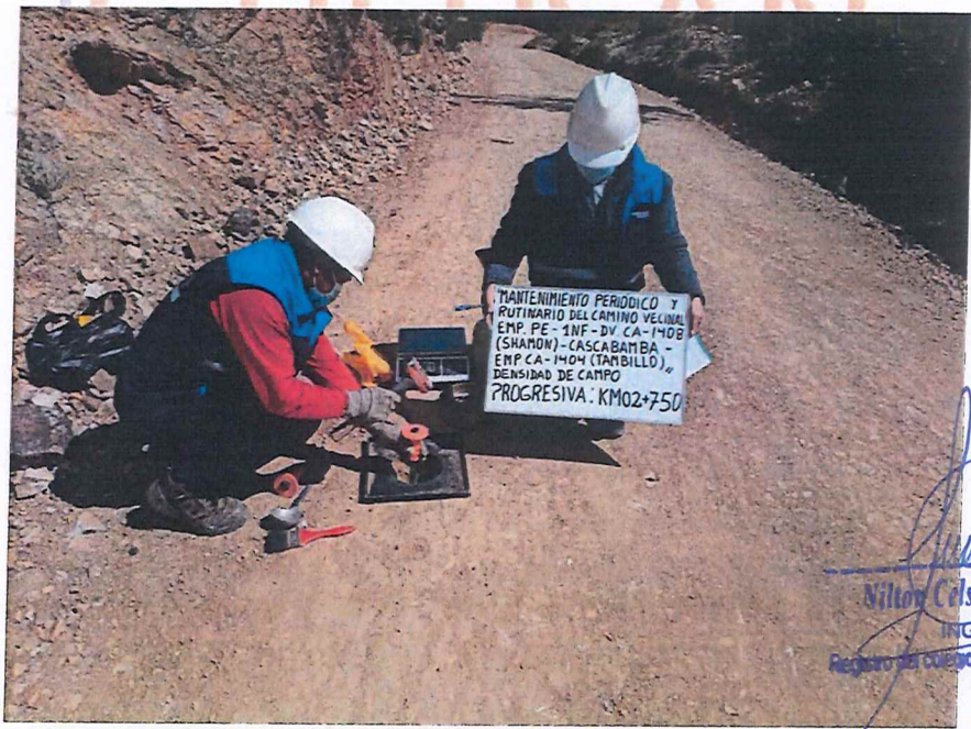
FIGURA N° 12. Ensayo de Densidad de Suelo en Campo. Progresiva 02 + 750 (Método del cono de arena).
