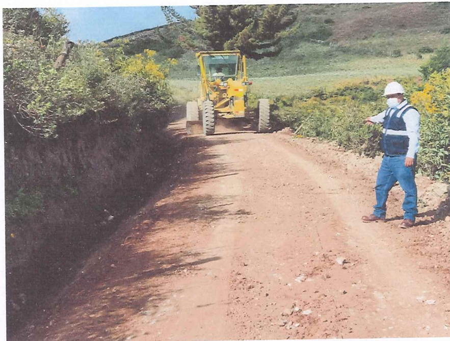
SE OBSERVA AL INSPECTOR DEL SERVICIO REALIZANDO LA VERIFICACION DE LA NIVELACION DE CAPA DE AFIRMADO CON MOTONIVELADORA. EN EL KM. 06+580.
