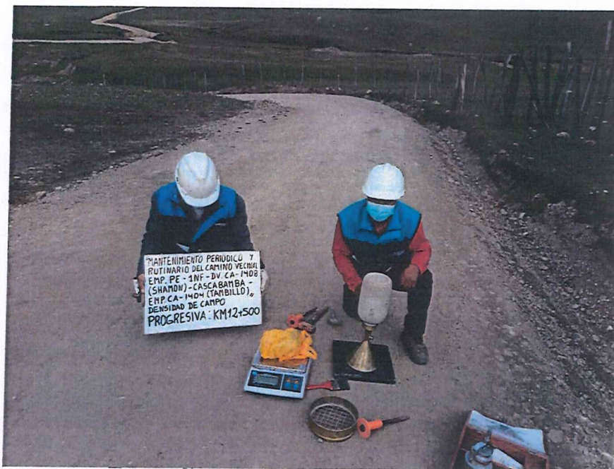
FIGURA N° 51. Ensayo de Densidad de Suelo en Campo. Progresiva 12 + 500 (Método del cono de arena).
